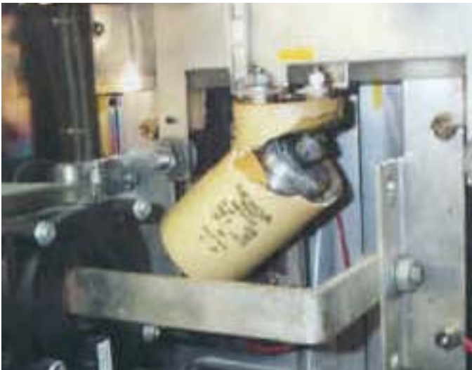
ภาพแสดงตัวอย่างแคปปาซิเตอร์ที่เสียแล้ว
